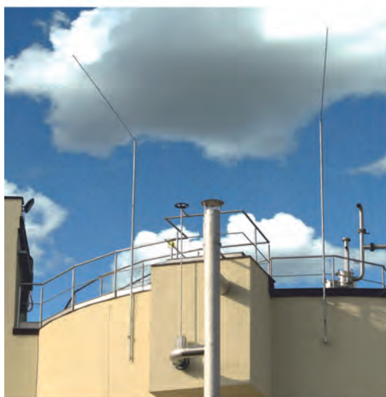
Maszty skrzywione w celu zwiększenia kąta ochronnego strefy wybuchu zbiornika.
